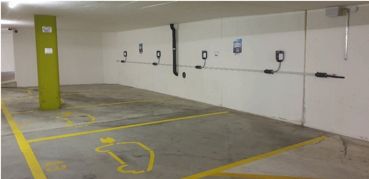
Einstellhalle Schloss Binningen mit vier Elektro-Ladestationen
