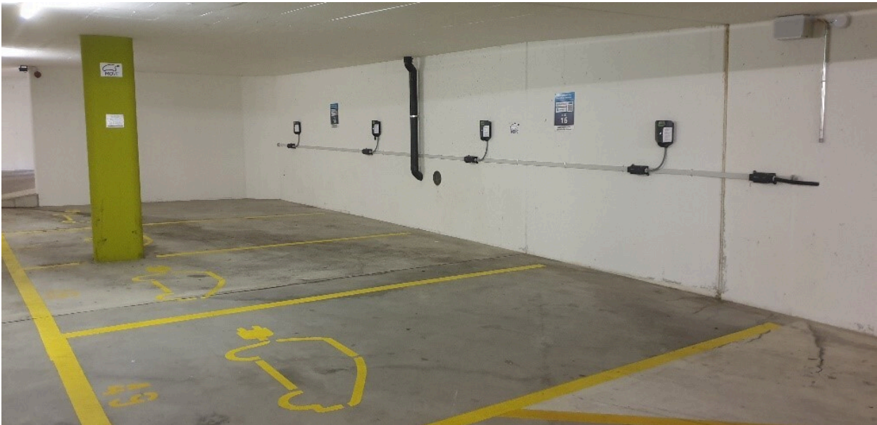
Einstellhalle Schloss Binningen mit vier Elektro-Ladestationen
