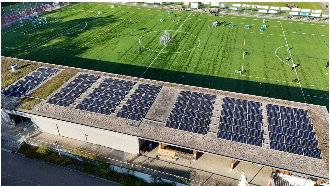
Fotovoltaikanlage Garderoben-/Tribünengebäude Spiegelfeld, Ziegelweg 4a / Foto: Max Schwank, 2025
