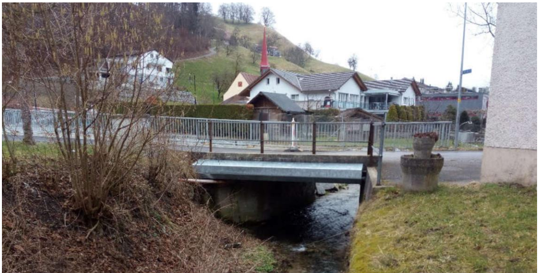
Abbildung 8: Beispiel für nachgerüstetes Stauschild an Brückenplatte
