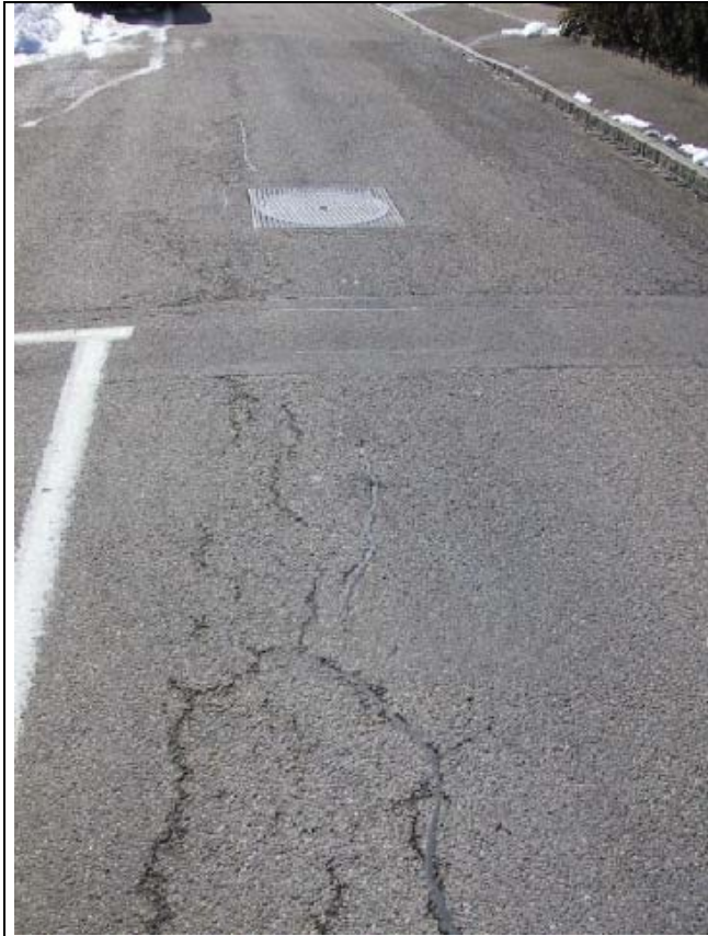
Steinenkreuzstrasse, Richtung Im Baumgarten, Belagsrisse und Auswaschungen
