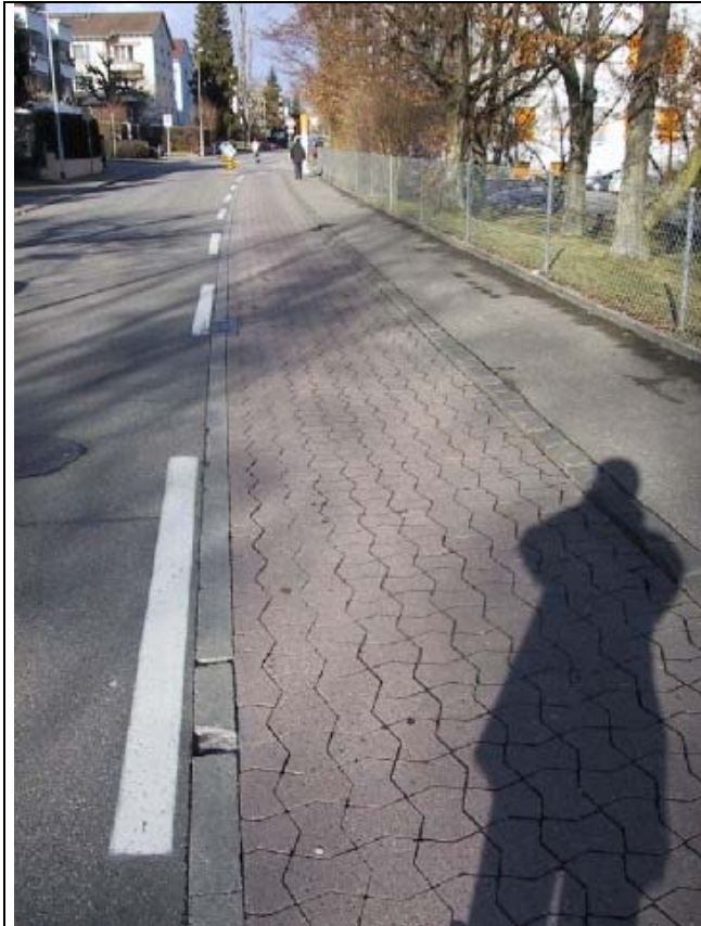
Radstreifen Schafmattweg, Richtung Gorenmattstrasse, Lose Verbundsteine und defekte Randabschlüsse gegen Fahrbahn
