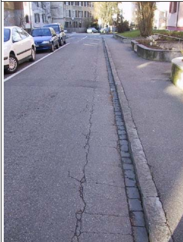
Amerikanerstrasse, Richtung Schlossgasse, Belagsrandrisse und Ablösungen
