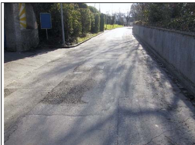
Friedhofstrasse, Höhe Sonnenbad, Kornausbrüche, Ablösungen und Belagsflicke
