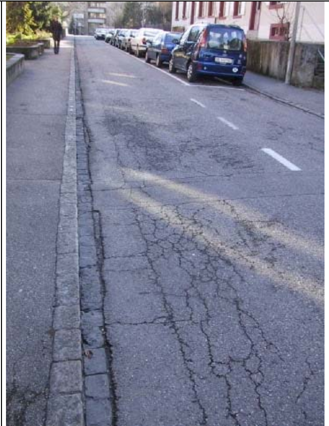
Amerikanerstrasse, Richtung Brückenstrasse, Rissbildung, Belagsrandrisse, Ablösungen und Belagsflicke
