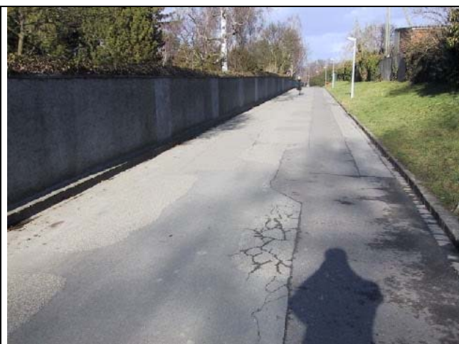
Friedhofstrasse, Richtung Venusstrasse, Netzrisse und Belagsflicke
