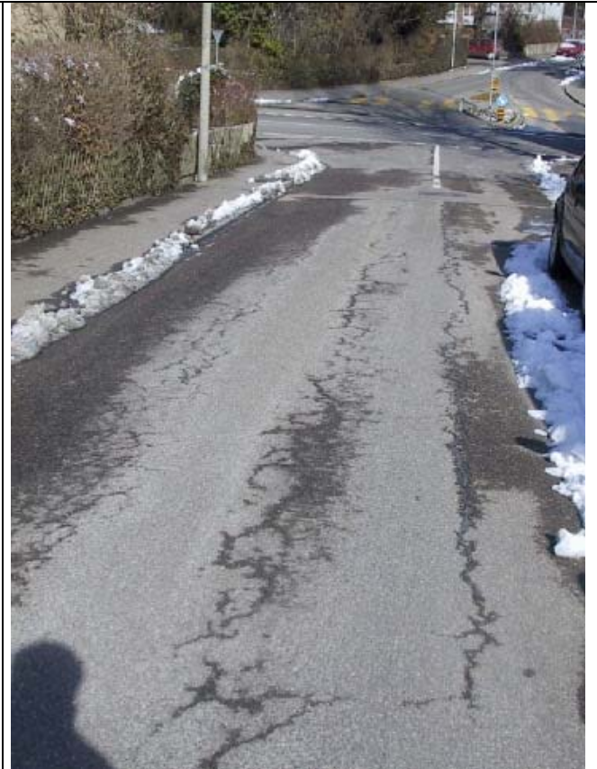
Steinenkreuzstrasse, Richtung Paradiesstrasse, Längs- und Netzrisse
