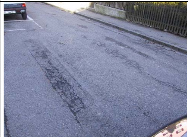
Amerikanerstrasse, Richtung Schlossgasse, Längs- und Netzrisse, Ablösungen
